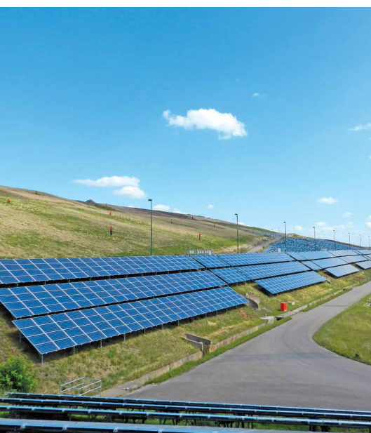
PV-Anlage am Fuße der Zentraldeponie Cröbern
